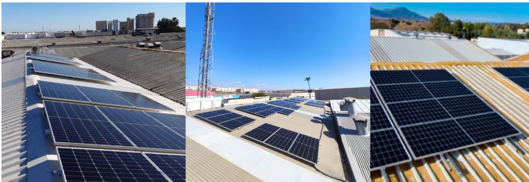
Imágenes de casos de éxito de instalaciones fotovoltaicas en empresas.
